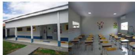
Ampliação de 02 salas - Escola Municipal Pe. Nazareno Lanciotti - Vale de São Domingos - MT.
